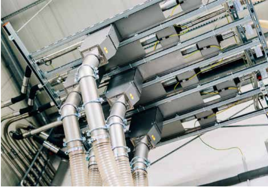
Bild 2. Blick von unten: Jede einzelne Förderleitung durchläuft einen eigenen Metallseparator. Aussortiertes Material fällt durch die Schläuche nach unten und wird getrennt gesammelt
